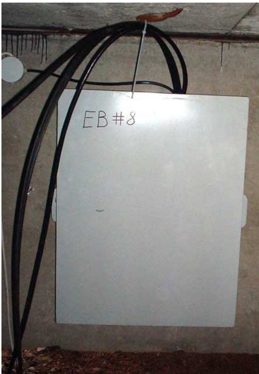
Рис. 2.4. Установка на техэтаже.
