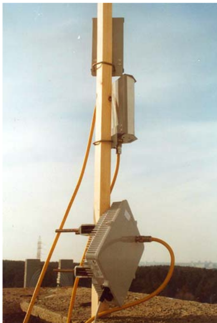
Рис. 5.4. Пример небольшой операторской базовой станции.
